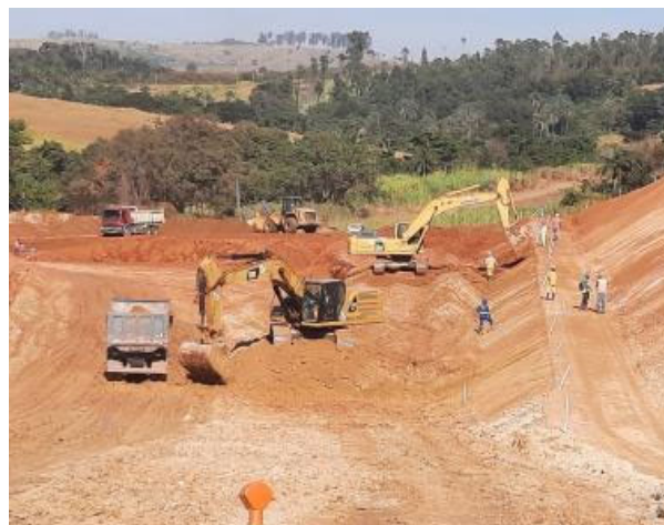
Foto 6: Escavação e remoção de material de 1ª cat. e execução dos taludes - vertedouro (25/05/2021)
